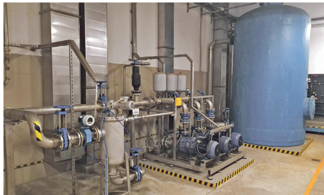
Instalacja wody technologicznej
