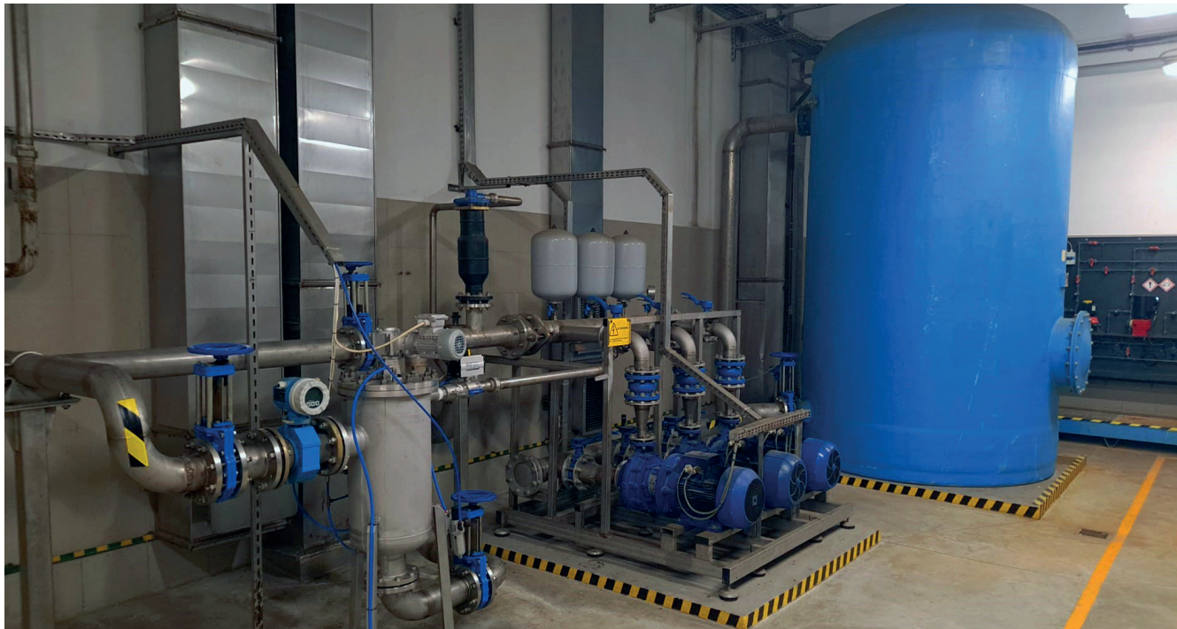
Instalacja wody technologicznej
